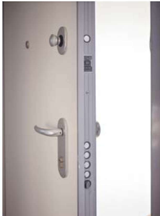
▲ Puerta de entrada a vivienda acorazada con cerradura de seguridad. Main Entrance armored door fitted with security lock.
