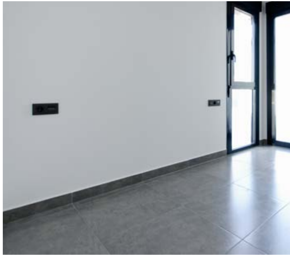
▲ Pavimento gris rectificado interior(60x60), exterior y solario (30x60) antideslizante. (60 x 60) grey porcelain-stoneware rectified and (60 x 30) exterior anti-slip flooring
